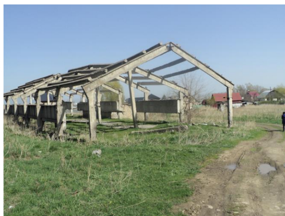
Рисунок 6 – Разрушенный склад на территории Кызылкайрат
