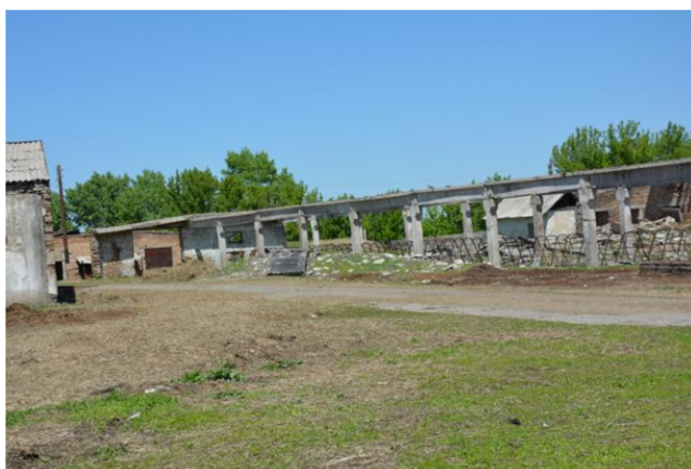
Рисунок 7 – Разрушенный склад на территории Амангельды
